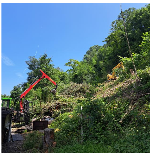
Figure 13 Eboulement à Delley-Portalban
